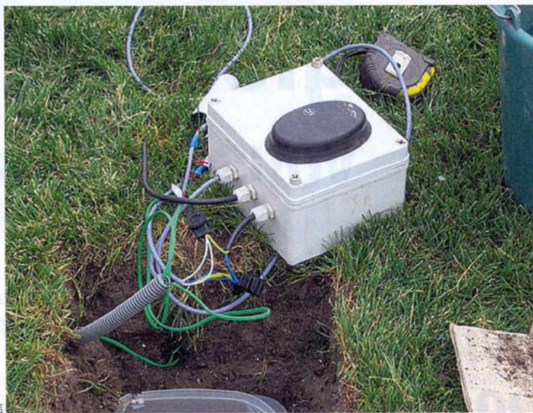
Le conseil général économise l'eau d'arrosage du gazon sur sept terrains du stade Yves-du-Manoir grâce à une meilleure connaissance de l'humidité du sol.
